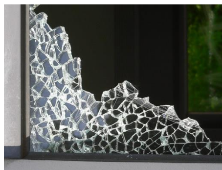
Figura 4 - Vidro Temperado Quebrado
